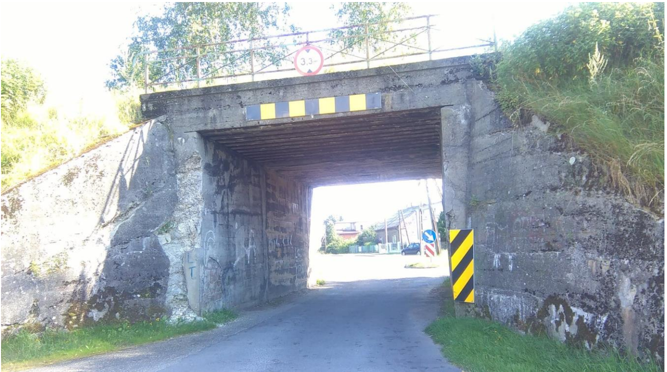
Ilustracja 35: Godów – nieczynny wiadukt kolejowy nad ulicą Olszyńską
