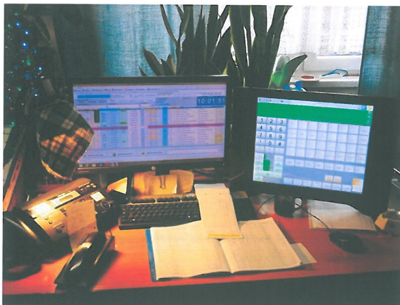
Fot.27. Stanowisko dyżurnego ruchu stacji Ozimek umieszczone po prawej stronie pulpitu nastawczego
