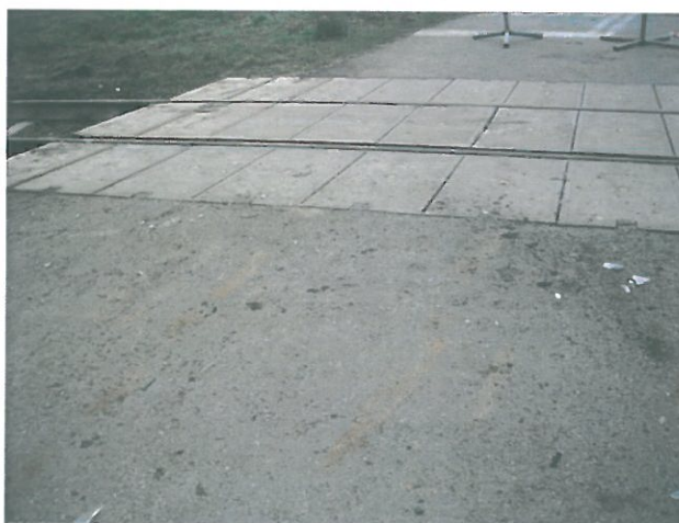
Fot. 17. Widoczne ślady zawieszenia się naczepy na przejeździe
