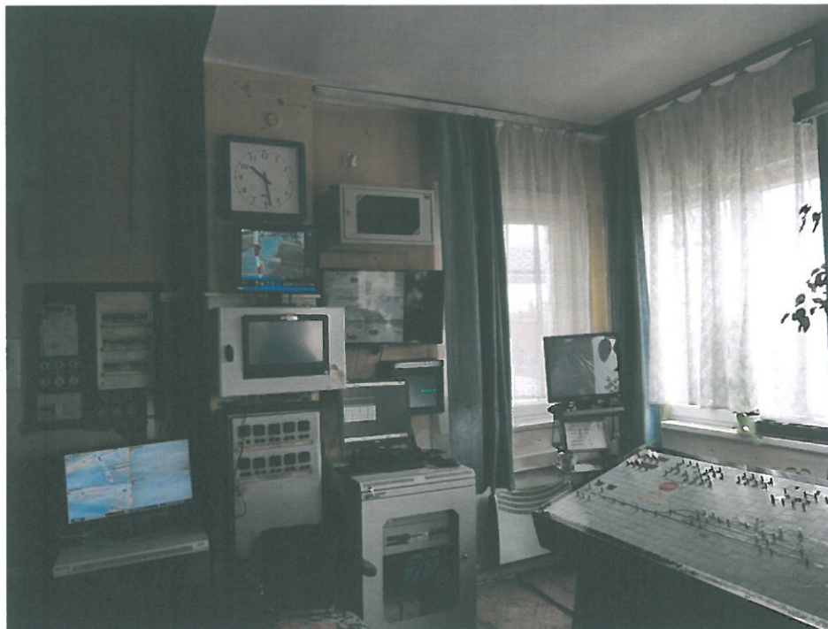
Fot.29. Monitory TVu umieszczone z lewej strony pulpitu w tylnej części pomieszczenia dyżurnego ruchu stacji Ozimek (zabudowane po poważnym wypadku dnia 20.11.2017r.)
