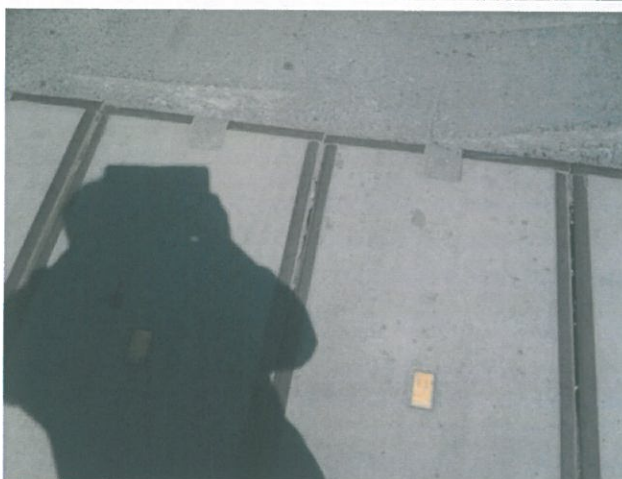
Fot. 16. Widoczne ślady na przejeździe
