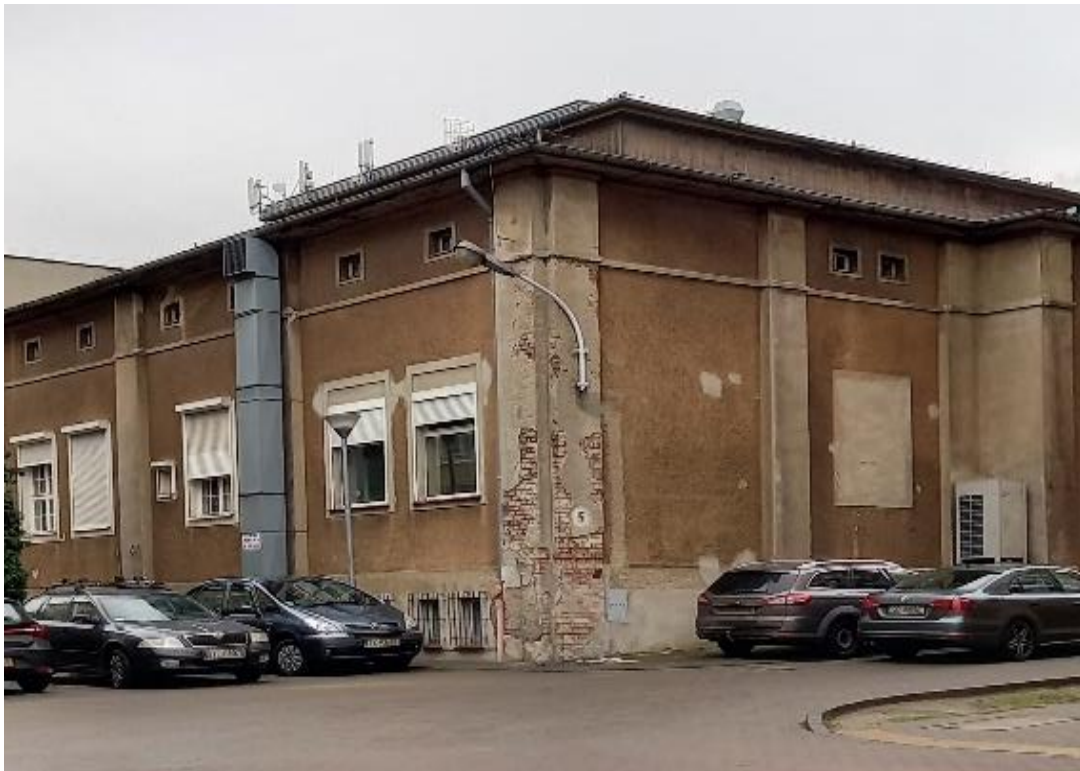
Zdjęcie nr 3 – Budynek 5A przeznaczony do rozbiórki.
